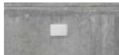
写真2 ICタグ(ID2)設置状況
