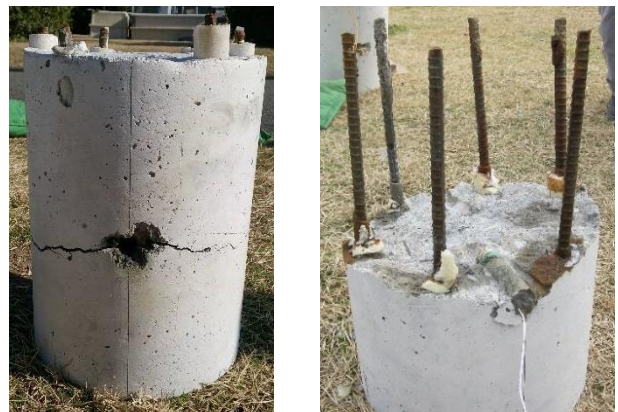
(a) 亀裂形成状態 (b) 杭頭処理部の状態
