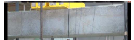
写真-2 ひび割れ(ヘッドスラブ中央)
