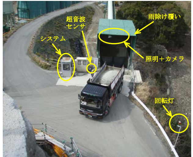
写真-1 現場での骨材粒径判別システムの設置
