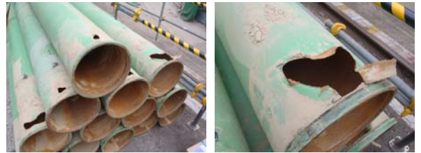
写真-1 排泥管摩耗状況
