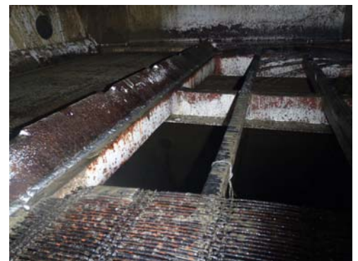
写真-3 一次処理機振動ふるい網損傷状況
