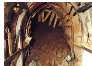
天端崩落状況
