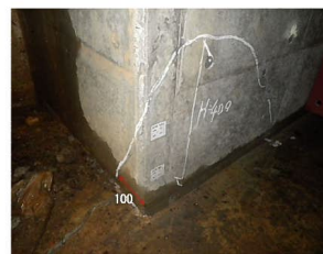
写真-1 変状箇所
