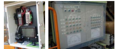
写真-2 側圧測定モニター（左）と型枠バイブレータ制御盤（右）
