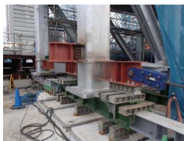
写真-2 柱廻り設備
