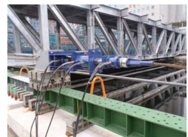
写真-3 牽引設備
