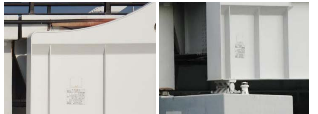
写真 8 補修履歴板の画像の比較 (左; UAV, 右; 地上)
