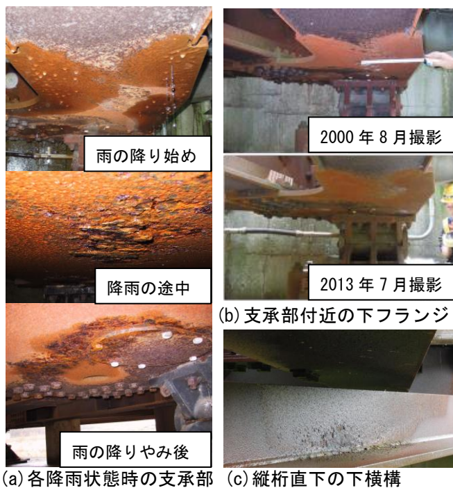
図-2 開床式で見られたうろこ錆
