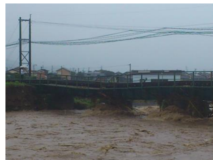
図3 被災状況(上流方より)
