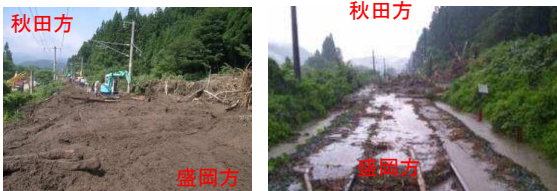
図-1 被災状況(1) 図-2 被災状況(2)
