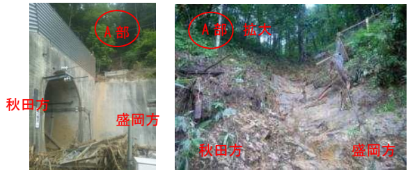
図-3 被災状況(3) 図-4 被災状況(4)
