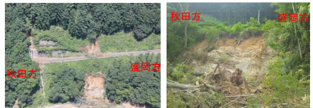
図-5 被災状況(5) 図-6 被災状況(6)
