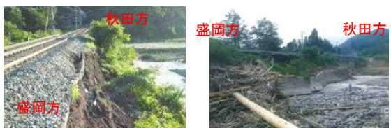
図-7 被災状況(7) 図-8 被災状況(8)
