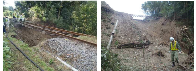
写真-1 崩壊状況(上部)
