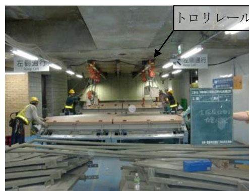
写真-1 大階段上部せり出し状況
