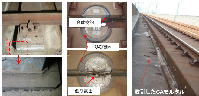
(a) 弾性材縁切れ (b) 突起の変状 (c) 防振スラブてん充層
