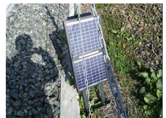
図-4 太陽電池パネル
