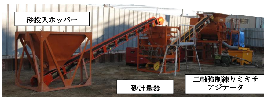
写真-3 遮水材料製造設備
