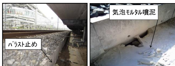
写真-1 気泡モルタル噴泥
