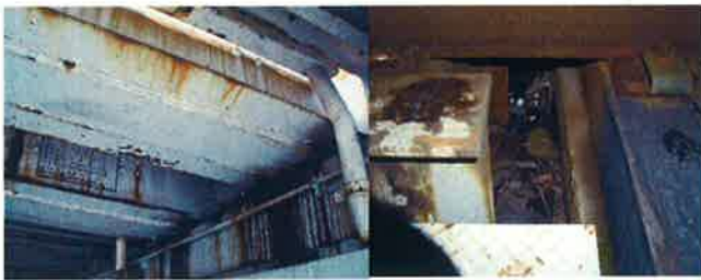
写真-2 下面・土砂堆積写真
