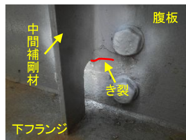
写真-2 補剛材下端変状
