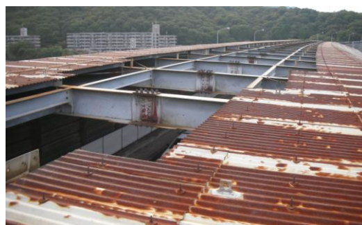
写真-1 西側シェルター開口部の発錆
