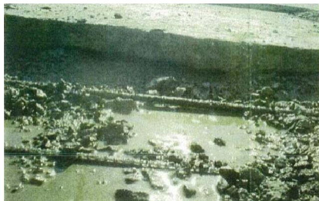
写真1 床版コンクリートの劣化状況
