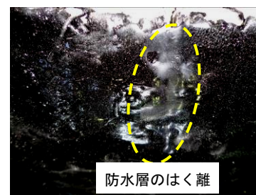
写真-8 CASE2 防水層の状態
