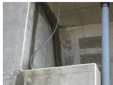
図-3 桁端部漏水状況
