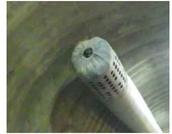
写真-1 特殊噴出ダクト
