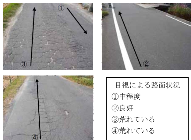
図-4 調査地点の路面状況
