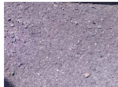
図-1 舗装表面の荒れ
