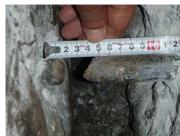
写真-2 ダウエルバーの状態 (R1 レン)
