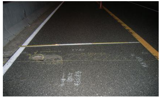
写真-1 損傷状況
