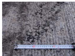
写真-3 荒い箇所の切削面
