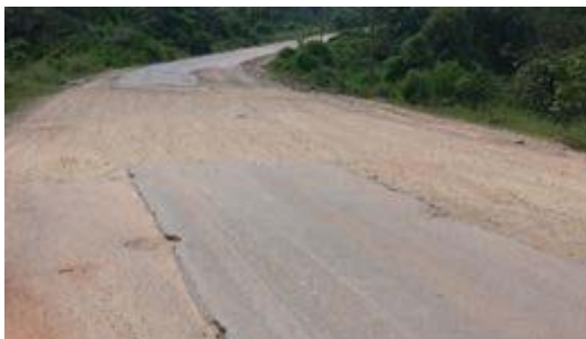
写真4 水みち区間（表流水の集中区間）における舗装の喪失（ガーナ）。
