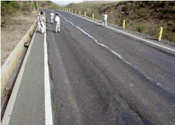
写真3 夏季の高温と重車両交通が多いことより、流動わだち掘れが多く発生している（エチオピア）。
