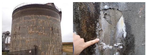
写真-1 珪酸ナトリウム系補修材料の再劣化状況
