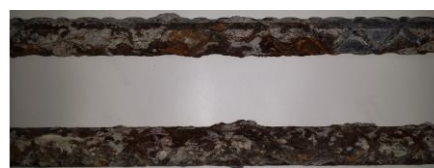
写真-3 普通鉄筋の腐食状況(下:20mm, 上:30mm)
