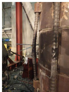
写真-4 補強鉄筋が降伏し、はらみ出し
