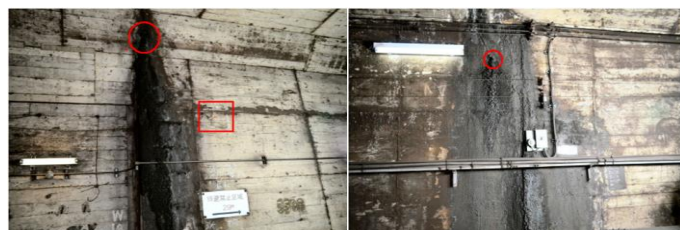
(a) 新規漏水箇所
