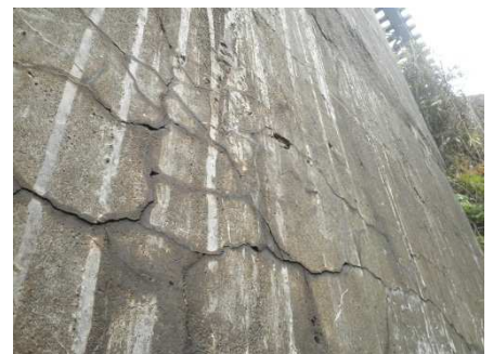
写真-2 1P 橋脚ひび割れ状況
