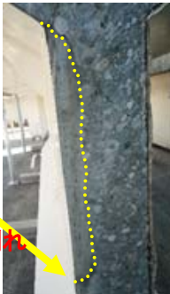
b) a-a' 断面の断面修復部
