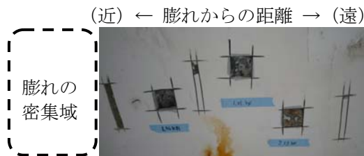
図3 膨れの位置と引き剥がし試験後の破壊状態の関係(張出し床版部)
