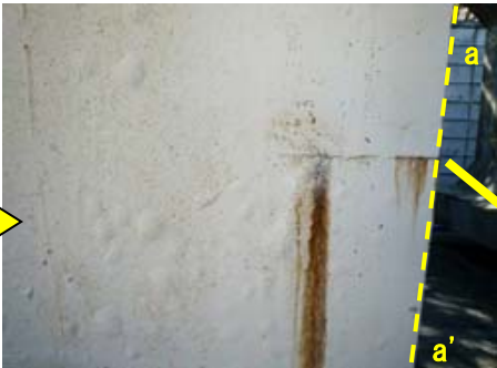
a) 断面修復部付近に生じた表面被覆材のひび割れと膨れ
