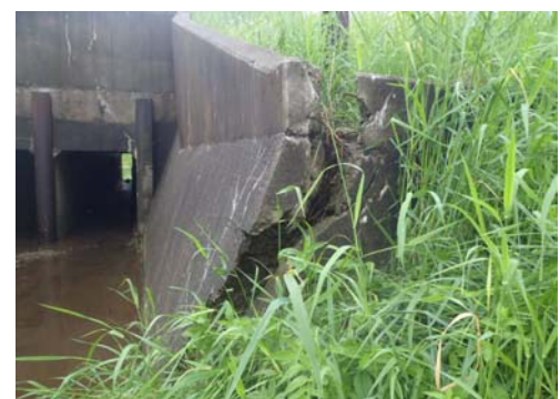
写真-3 土圧の影響が疑われる事例（川裏側翼壁，劣化度 III）
