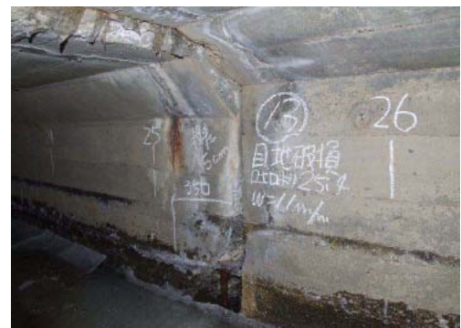
写真-2 不同沈下により継手部に目違いが生じている事例（劣化度 IV）
