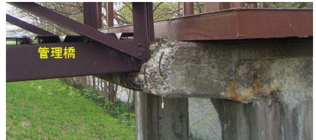
写真-1 管理橋の落下が懸念される事例（劣化度 III）
