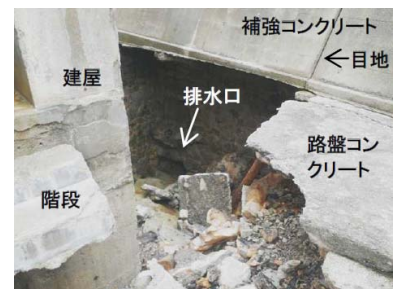
写真 2 護岸の変状の一例 (平成 24 年調査時)
