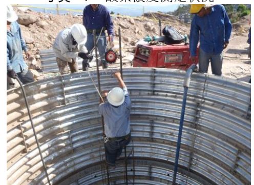
写真-5 落下防止装置付き昇降階段
