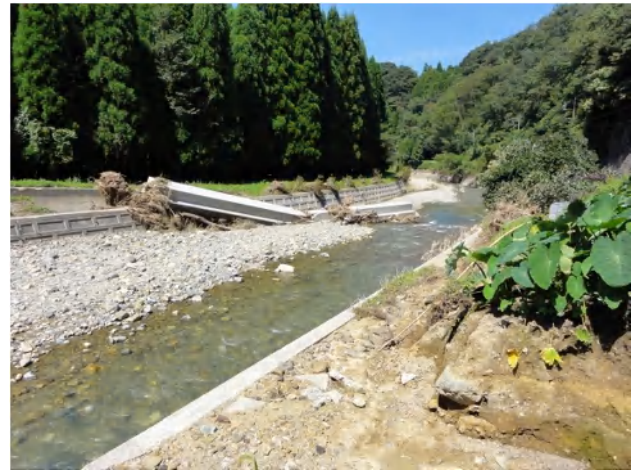
写真 2 敬川上流の橋桁流失
