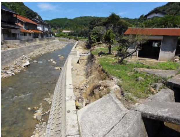
写真 1(b) 目田川における土石流(下流から)
