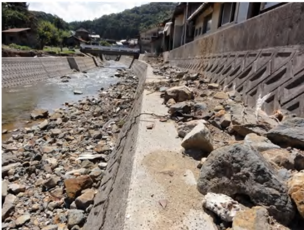
写真 1(a) 目田川における土石流(上流から)
