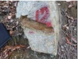
写真-5 叩き落し後 (箇所11)
