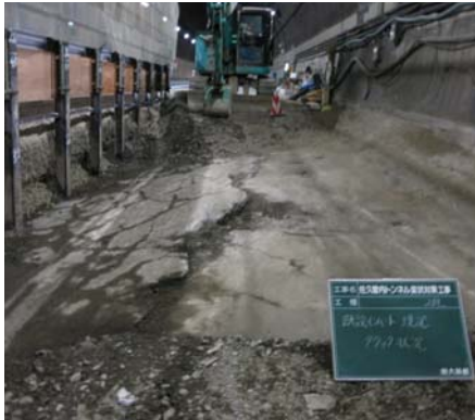
図3 インバート破壊状況写真
