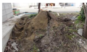
写真-1 水による破壊
