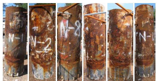
写真-2 実腐食計測試験体
