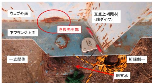
a) 疲労き裂発生部 周辺
