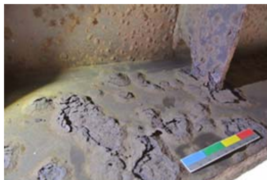
図-2 こぶ状さび（経過 28 年，離岸 5km）
