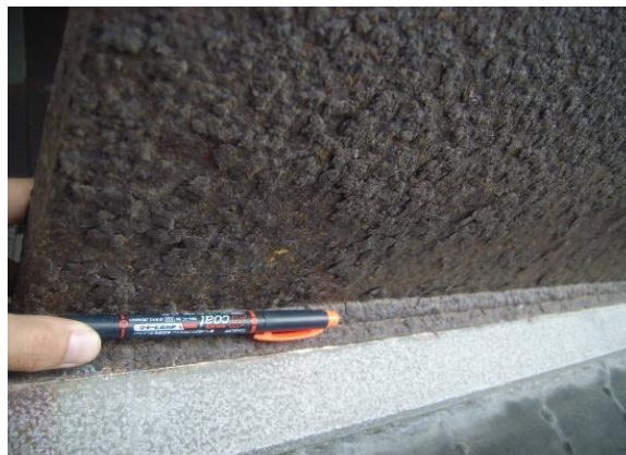
写真1 A橋 橋脚周辺の南側桁の下フランジ下面
