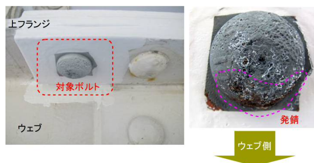
図-6 SZ 施工困難部における発錆(ウェブ近傍)
