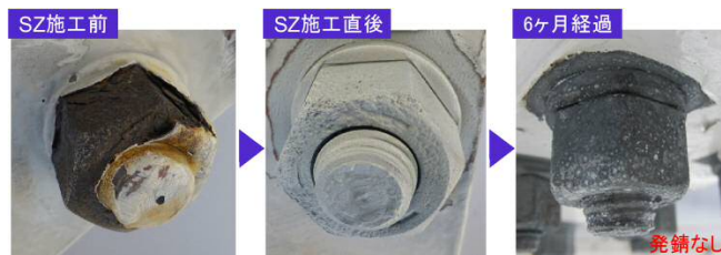
図-5 SZ 施工部の高力ボルトの経時変化
