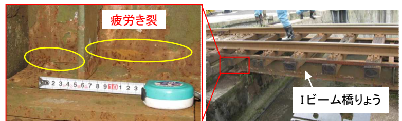
図1 Iビーム橋りょう 疲労き裂の例
